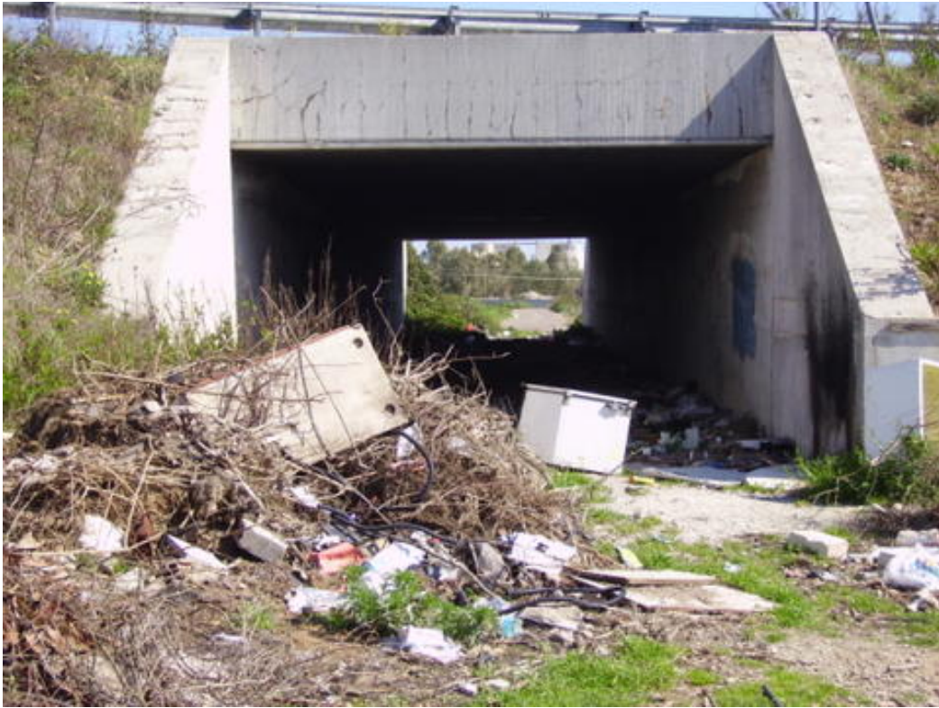
Cumuli di rifiuti e materiali di risulta che bloccano il passaggio.
